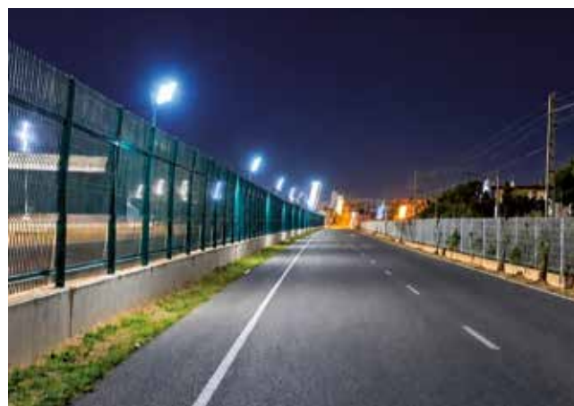
Fotografía: Las nuevas farolas solares.
