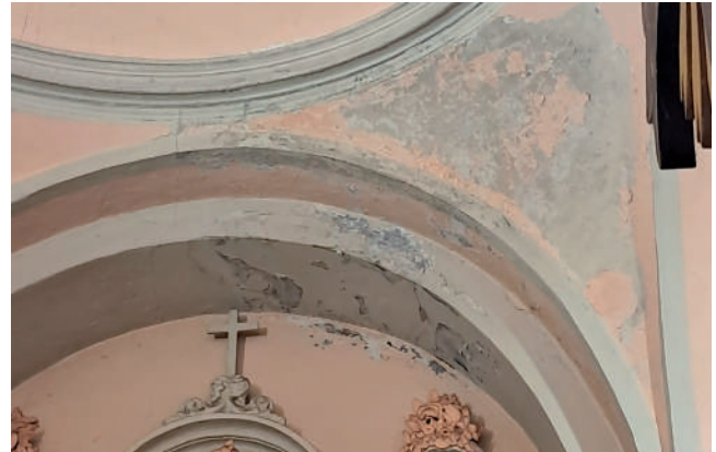
Fotografía: Deterioros en las cubiertas de las capillas laterales.
